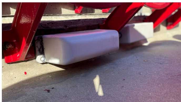
図 1 スタジアムのシート下に設置された 5Gミリ波のsmallセル
